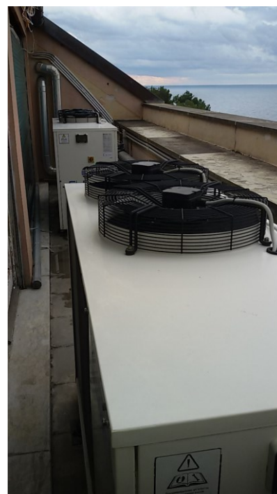
Figura 4.9 - Particolare delle pompe di calore Clivet WSAN XEE 82
