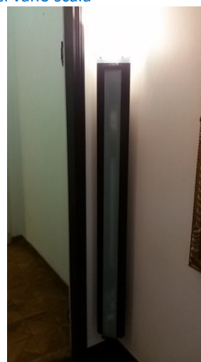
Figura 4.13 - Particolare dei corpi illuminanti ubicati nel vano scala
