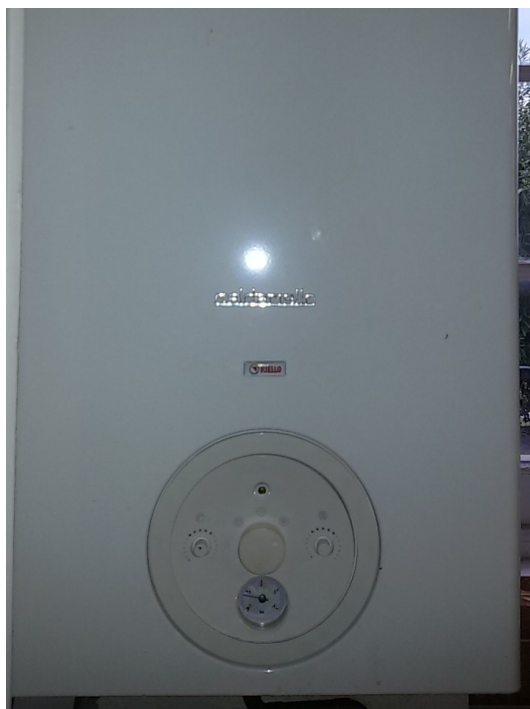
Figura 4.8 - Particolare della caldaia Riello Caldarello 24 KIS
