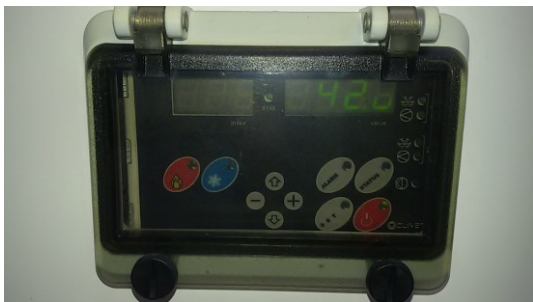
Figura 4.5 - Particolare della centralina di controllo di una pompa di calore
