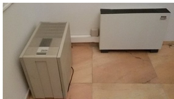
Figura 4.4 – Particolare dei ventilconvettori installati nelle sale espositive
