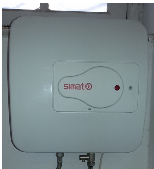
Figura 4.10 - Particolare di un boiler elettrico per la produzione di acqua calda sanitaria
